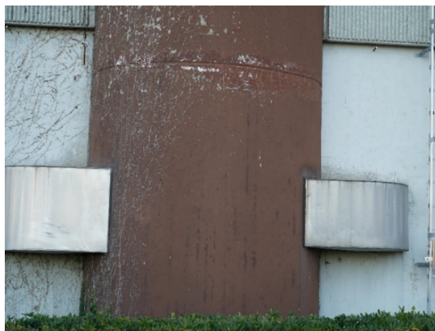
Figura 4-7: immagine della centrale termica ritagliata
