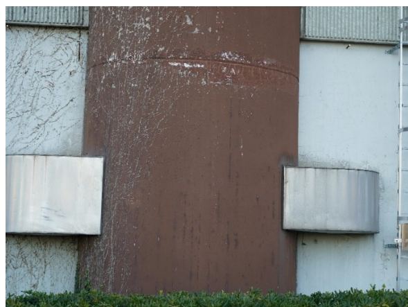
Figura 4-2: immagine della centrale termica ritagliata
