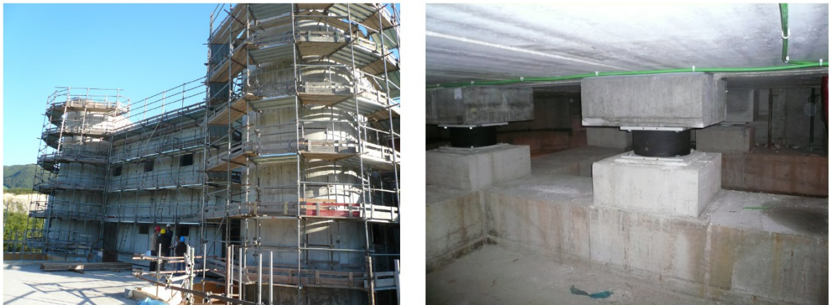
Figura 2.40 Scuola Marzabotto e vista di alcuni isolatori
