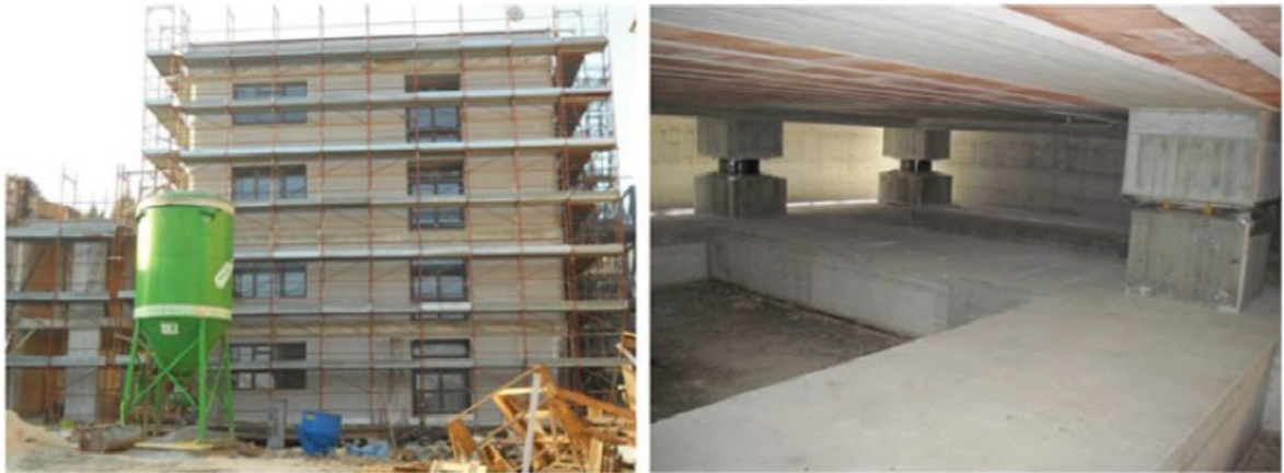
Figura 2.41 Blocco B del liceo Romita e vista di alcuni isolatori
