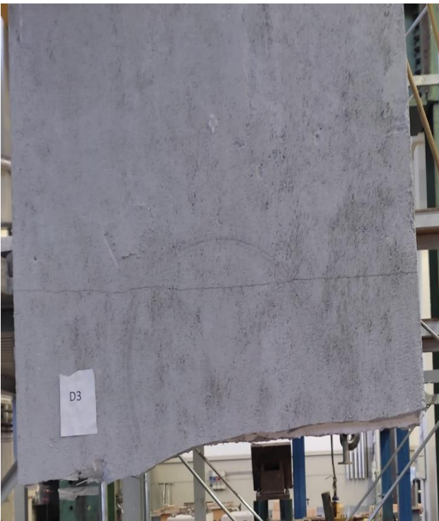
Figura 42 - Rottura per pressoflessione D3
