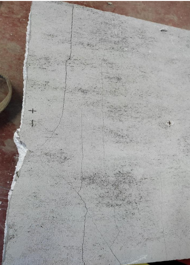
Figura 40 - Rottura per pressoflessione D1
