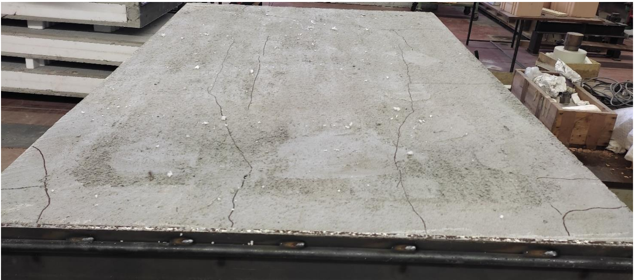
Figura 41 - Rottura per pressoflessione D2
