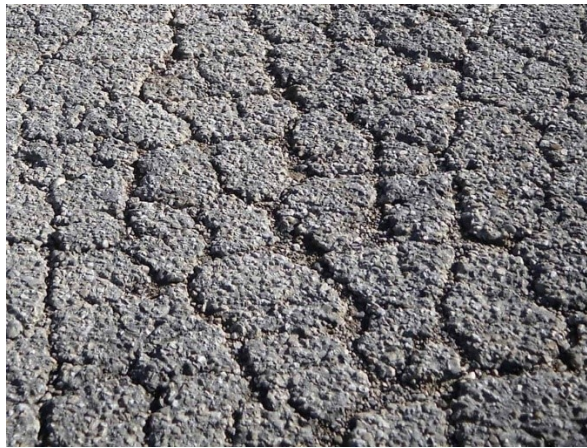
Figura 2.3 – Fessurazioni a fatica
