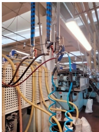
Figura 1: i due tubi a sinistra trasportano il liquido refrigerante (acqua e antigelo) fino la macchina, la tubazione a destra trasporta l'aria compressa
