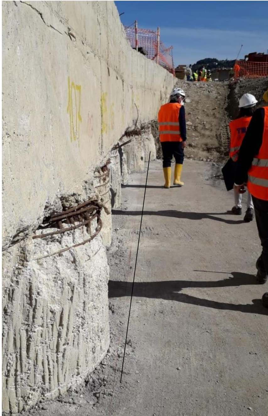
Figura 4.1. Disallineamento dei pali
