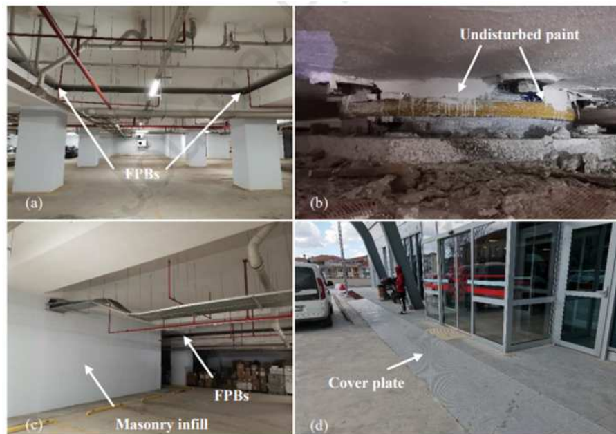
Fig. 2.45_ Strato di isolamento di B2: (a) posizione degli FPB, (b) un FPB con vernice indisturbata, (c) riempimento in muratura intatto nello strato di isolamento e (d) piastra di copertura intatta sopra la fessura di isolamento.
