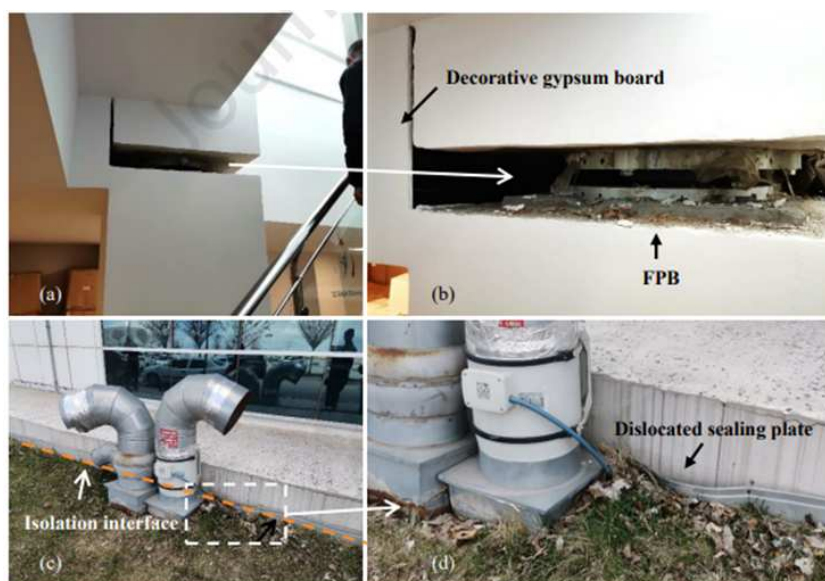
Fig. 2.49 _Danno minore a B4: (a) e (b) FPB esposto, (c) interfaccia di isolamento e (d) piastra di tenuta dislocata.
