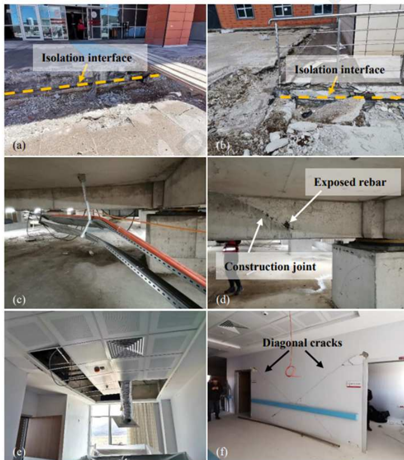
Fig. 2.47_Danni osservati all'edificio B3 isolato alla base dell'ospedale statale di Doğanşehir
