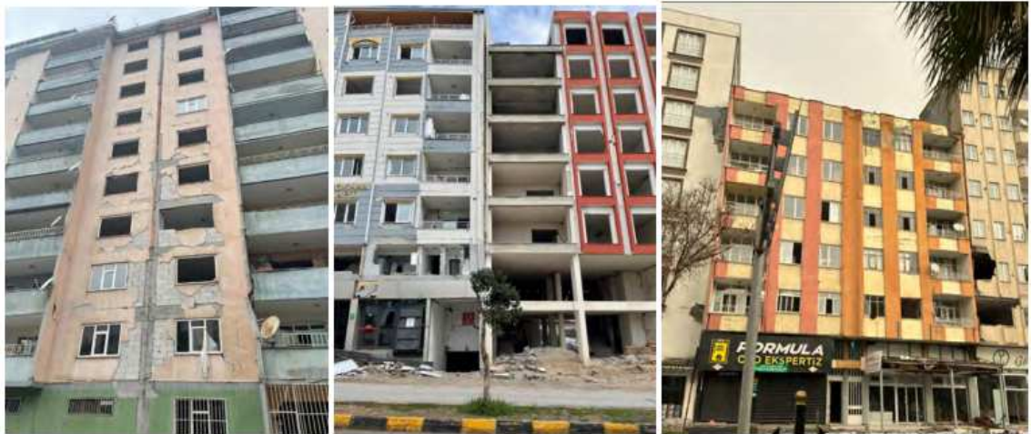
Fig. 2.18_ Separazione insufficiente nei giunti sismici tra edifici
