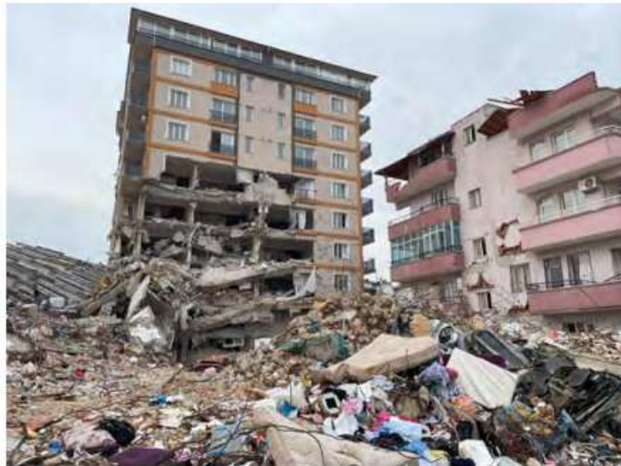
Fig. 2.19_ Struttura impattata dagli edifici vicini (effetto martellamento)
