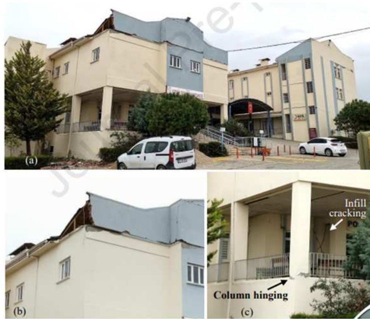
Fig. 2.38_Danni all'edificio F7, Ospedale statale di Erzincan
