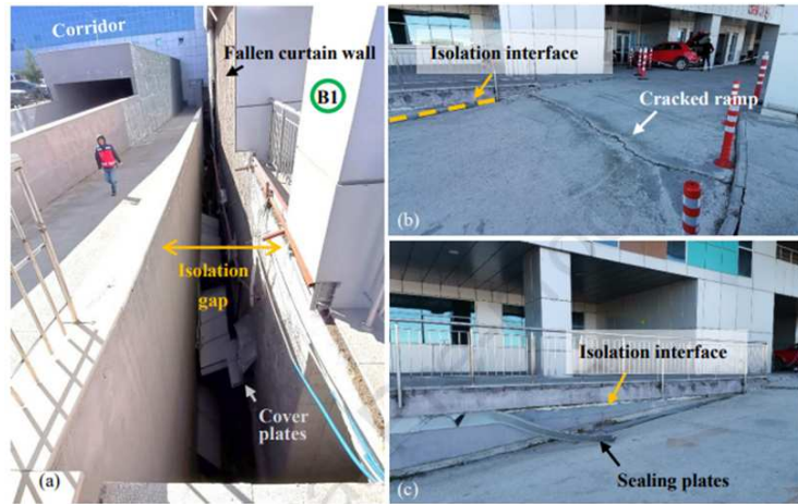
Fig. 2.43_Danni non strutturali intorno allo strato di isolamento di B1
