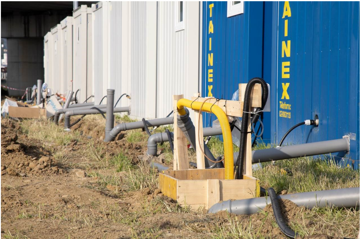
Foto 2.3 Area di accoglienza Guidoni – impianti scarico (foto L.Ciarleglio)
