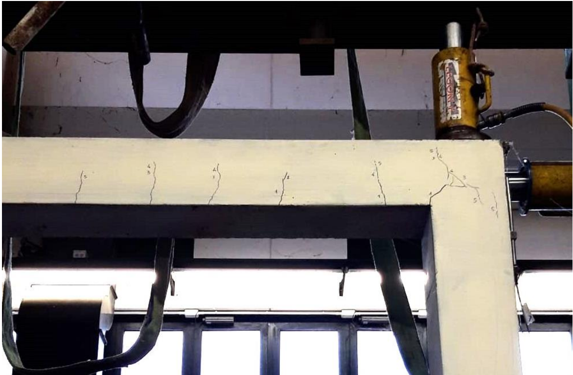
Figure 2.24 - FESSURAZIONE COMPLESSIVA DEL MODELLO
