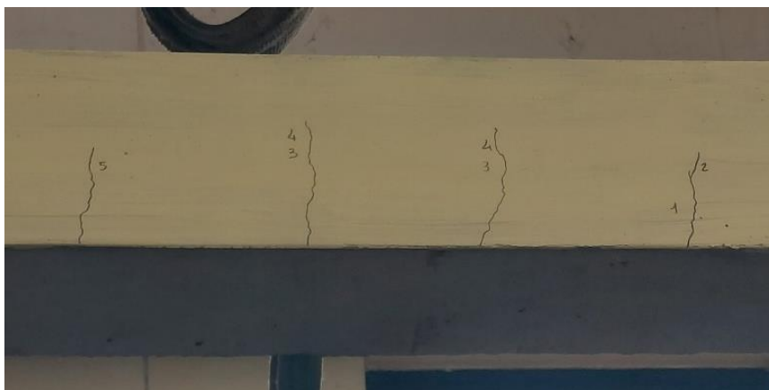
Figure 2.21 - FESSURE DA FLESSIONE SULLA TRAVE
