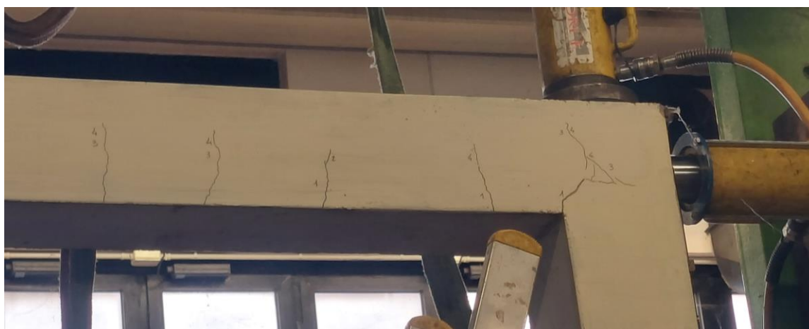
Figure 2.22 - FESSURE PRIMA DELL'ULTIMO CICLO DI CARICO
