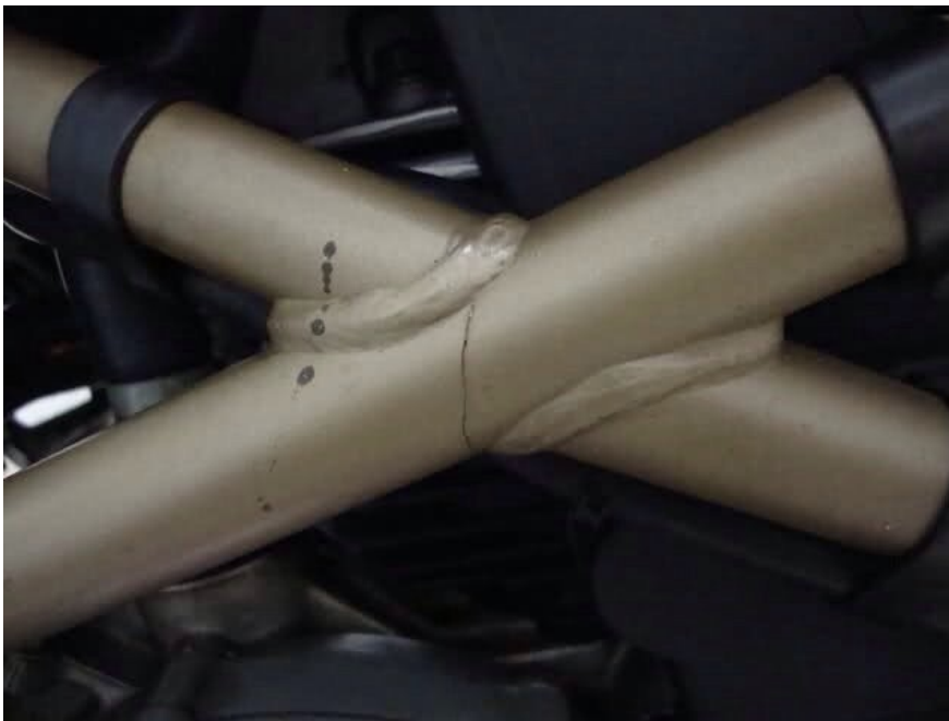
Fig. 1.6 cricca all'interno di un telaio motociclistico in acciaio legato, causata probabilmente dalla presenza di tensioni residue o da alterazioni localizzate della composizione chimico-fisica del materiale.
