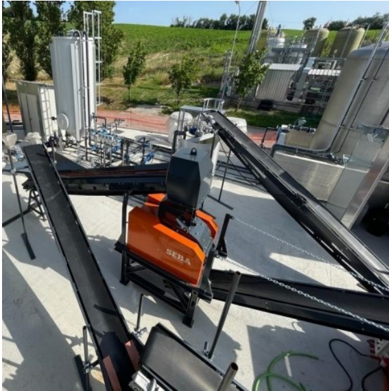
Figura 6- Particolare dell'impianto di trattamento: nastri estrattori e sezione di triturazione.
