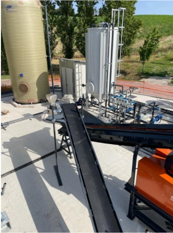
Figura 5- Particolare dell'impianto di trattamento: nastri estrattori e sezioni di lavaggio e dosaggio reagenti.
