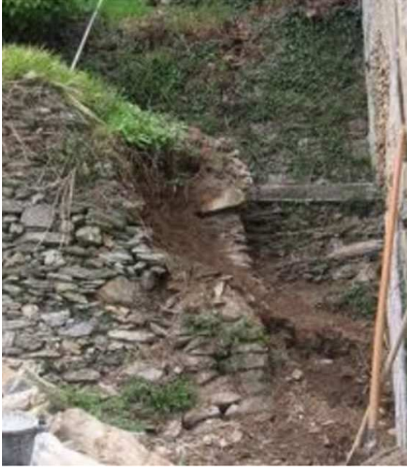
Figura 4-5 L'abbandono dell'uso agricolo dei versanti terrazzati e delle pratiche di manutenzione possono determinare in breve tempo il degrado delle strutture. Interruzione di una serie di piccole e incessanti operazioni quali ad esempio la pulizia delle canalette di drenaggio, l'esecuzione di piccoli interventi di manutenzione dei muretti a secco.
