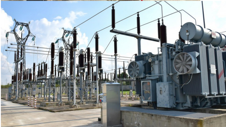
Figura 1-3: Tipici esempi di cabina secondaria (in alto) e primaria (in basso).
