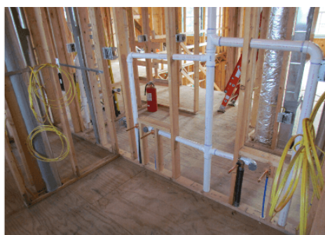
Figura 1.7: Impianto idraulico a parete
