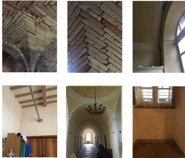
Figura 24: Alcuni danni successivi al sisma del 2016
