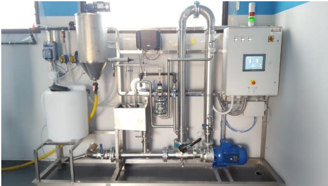
Figura 15 Unità di filtrazione con membrane ceramiche per la separazione solido/liquido e cristallizzatore per produzione di Sali di fosforo
