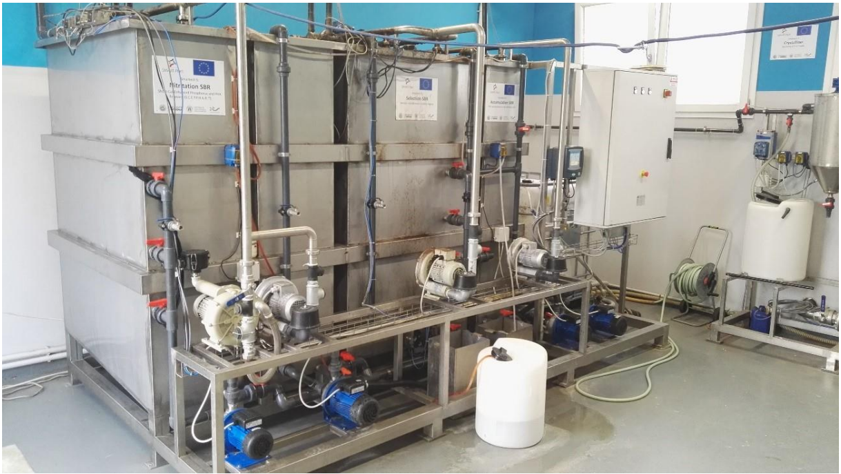
Figura 16 Moduli N-SBR (Nitritazione), S-SBR (Selezione), A-SBR (accumulo)
