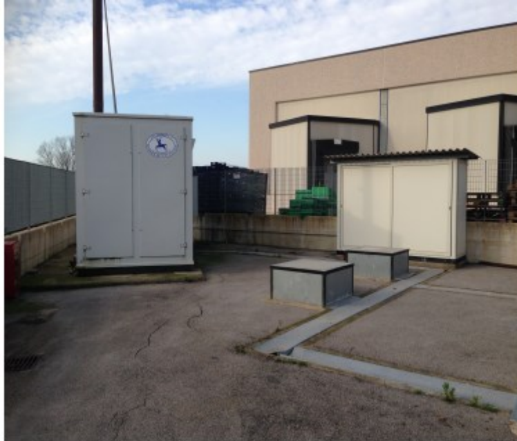
Figura 4.2: Motore di cogenerazione
