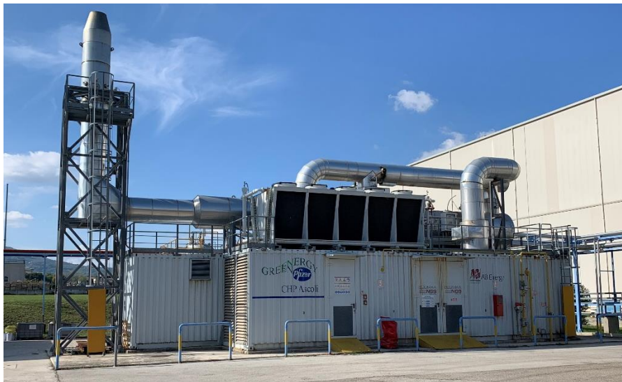
Figura 8: Parte dell'Impianto fotovoltaico e il Cogeneratore installati nello stabilimento
