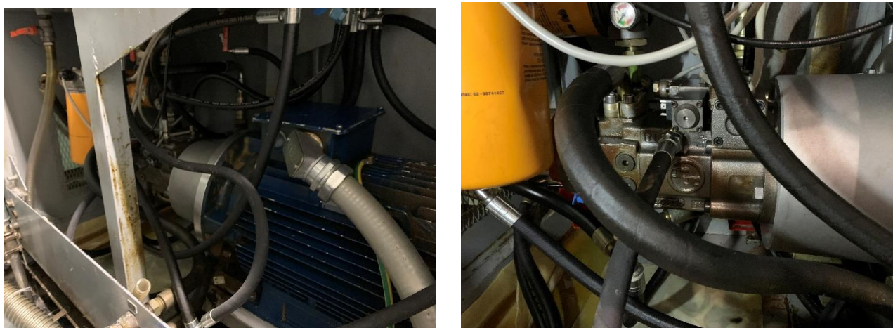
Figura 27: Motore trifase che spinge la pompa idraulica a servizio del roto-granulatore
