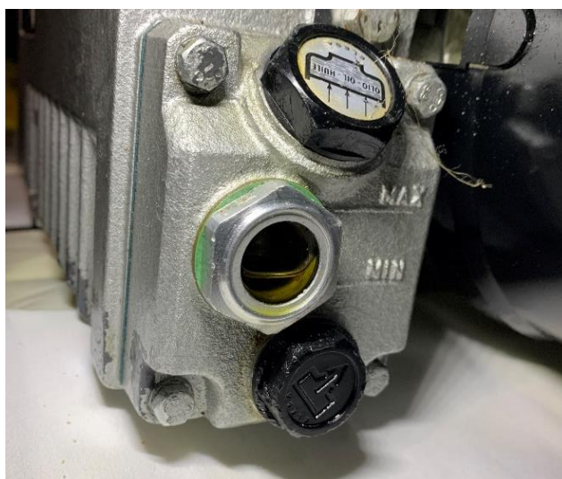
Figura 39: Specola dell'olio di lubrificazione della pompa del vuoto
