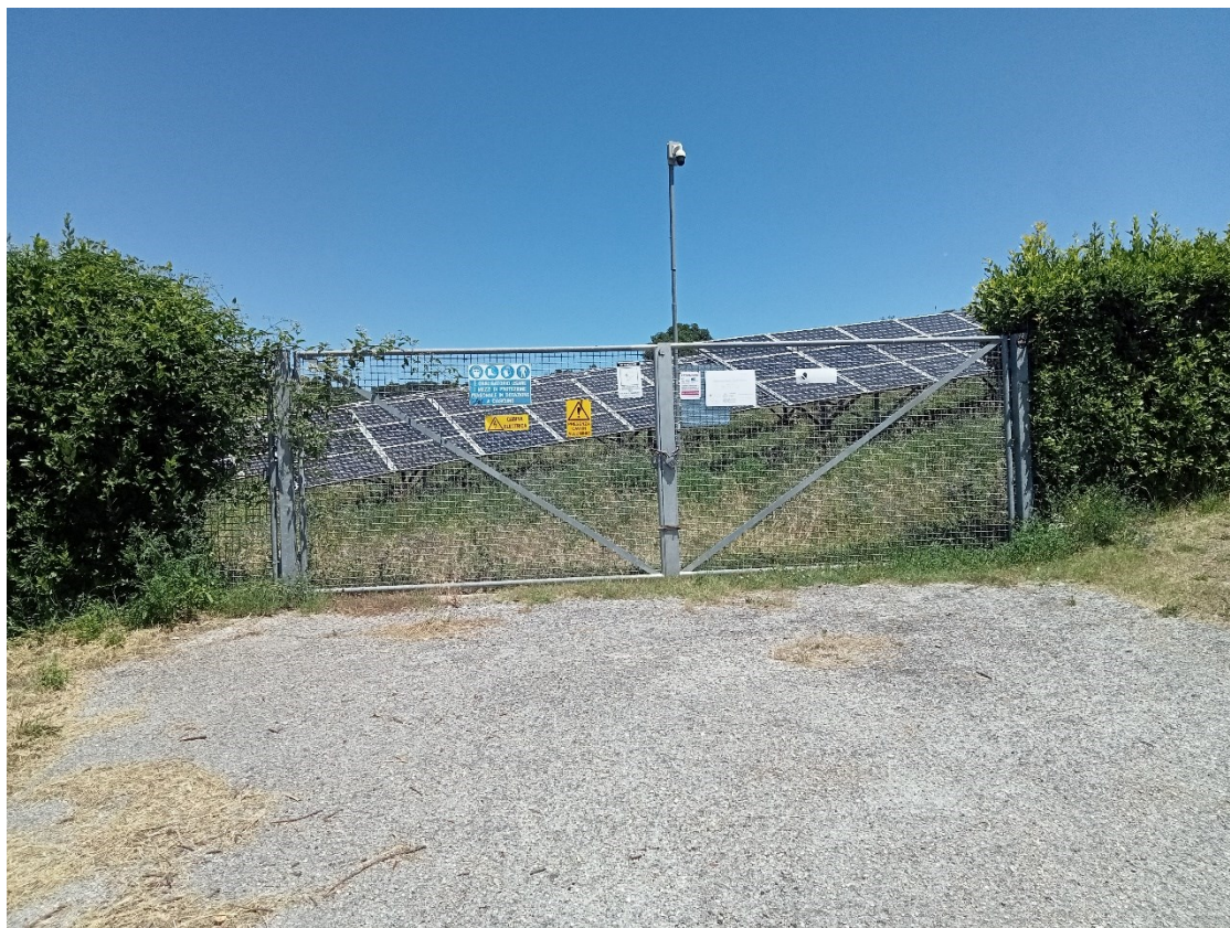
Figura 49 - Fotografia ingresso impianto fotovoltaico
