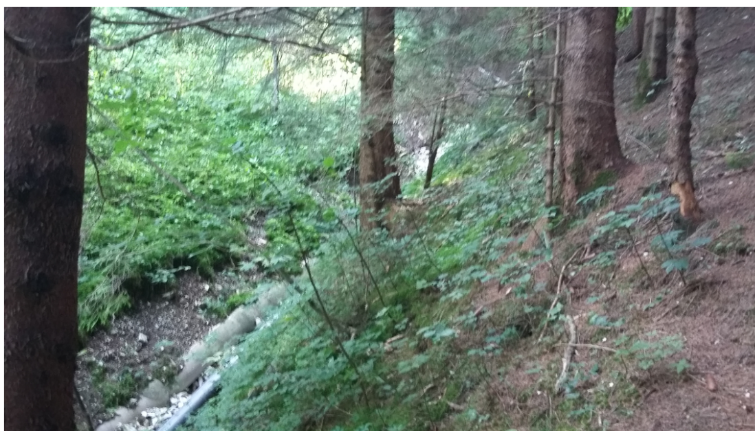
Figura 3- 1 Foto punto a valle della imhof in tratto impervio e con condotta esposta
