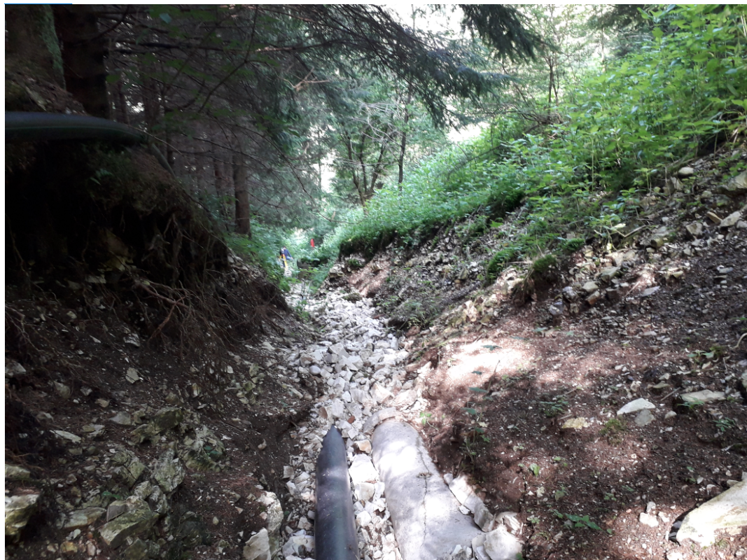
Figura 3- 1 Foto punto a valle della imhof con condotta esposta
