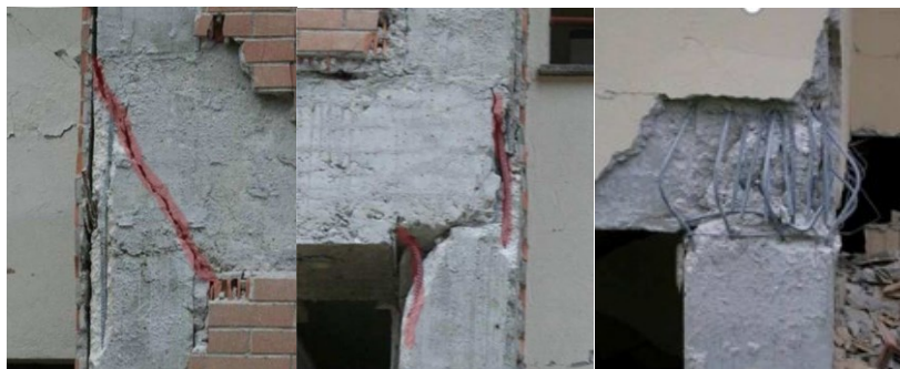
Figura 1. 7 Rottura a taglio del nodo trave-pilastro per mancanza di armatura trasversale nel pannello nodale
