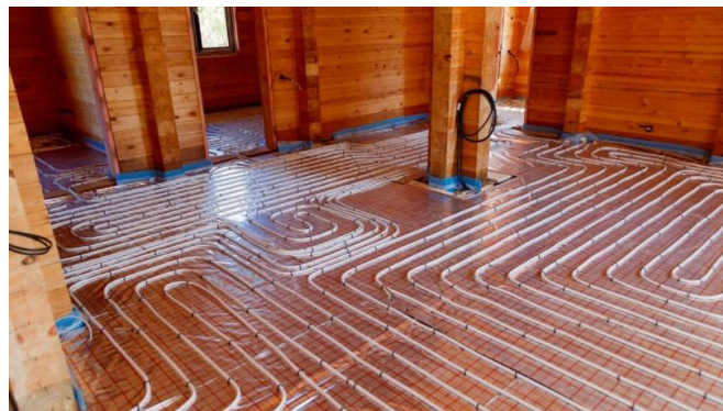
Figura 3.2 Pannelli radianti con installazione a pavimento, prima di eseguire la gettata di cemento.[10]
