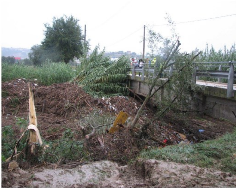
Fig. 3.5 Occlusione a monte del ponte del Fiume Aspio
