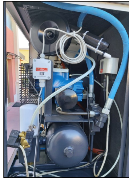
Figura 5.10: Posizione sensore temperatura e umidità relativa dell'aria aspirata con dettaglio sulla vista laterale del vano di compressione e serbatoio dell'olio
