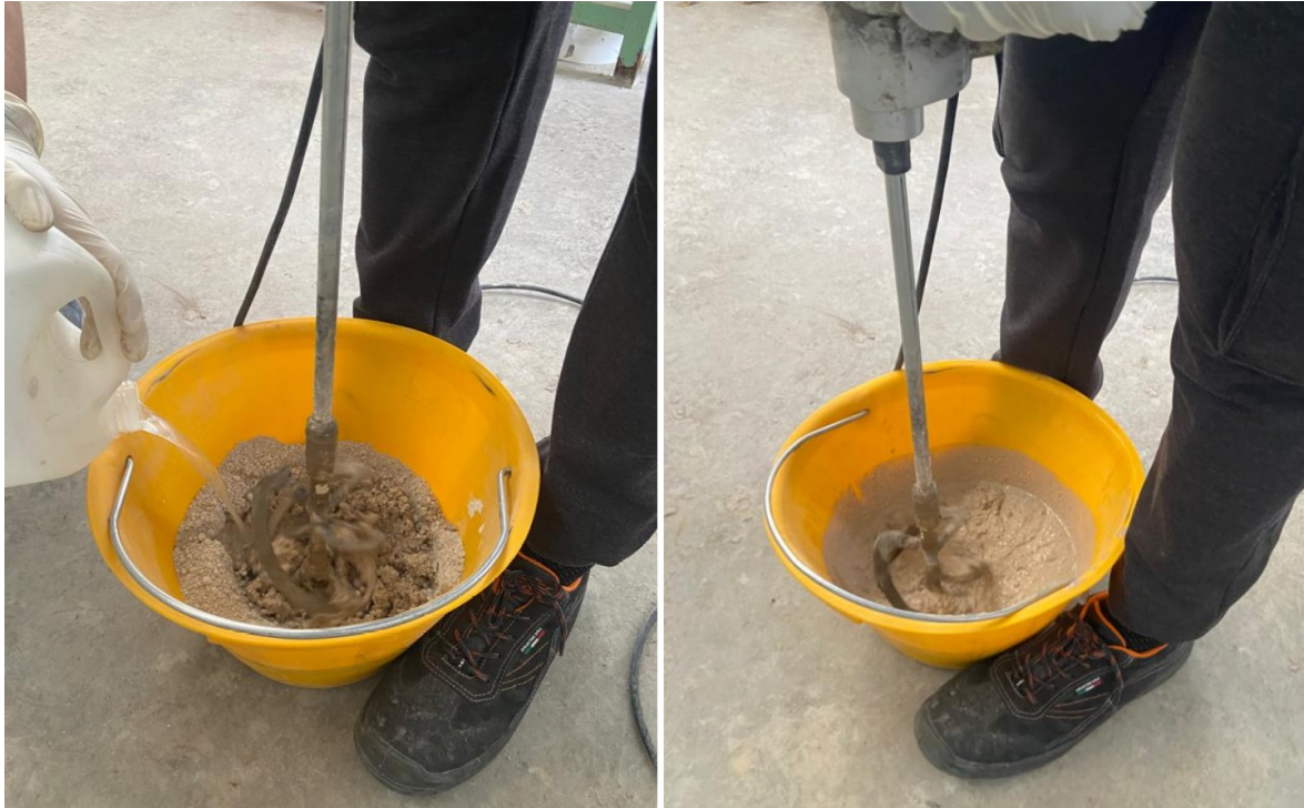
Figura 55: Omogeneizzazione impasto con trapano miscelatore (a); impasto omogeneo pronto per il getto (b).
