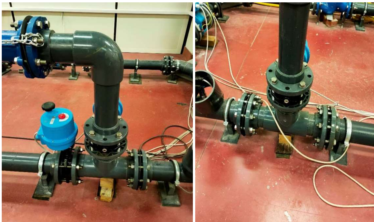
Figura 5. Valvole motorizzate per il collegamento della linea principale e quella secondaria.
