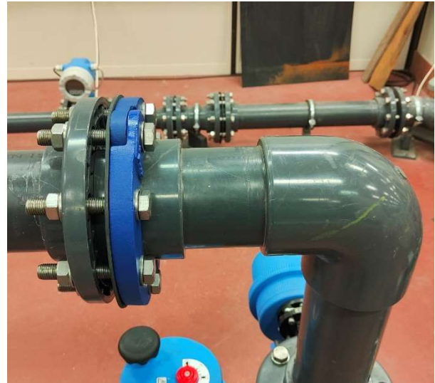
Figura 13 b. Imbocco flangiato a monte dx.
