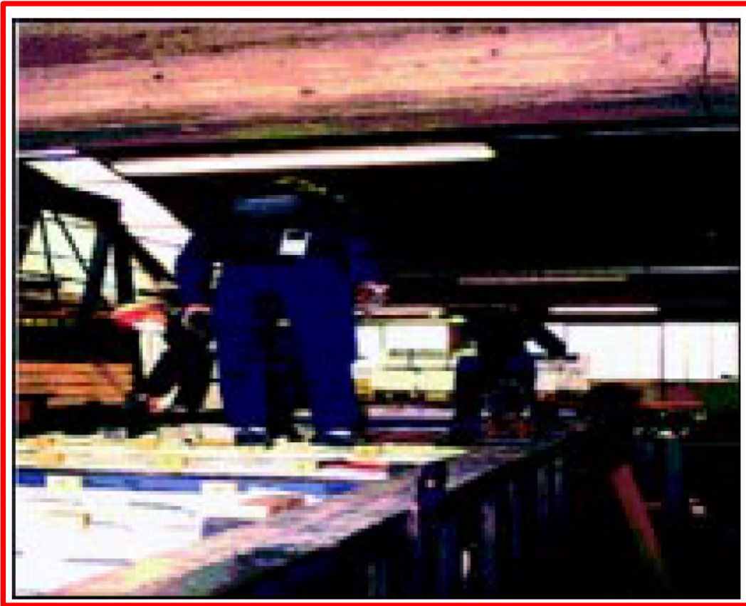
6: Montaggio del rivestimento in FCR sul tetto di un forno per ceramiche
