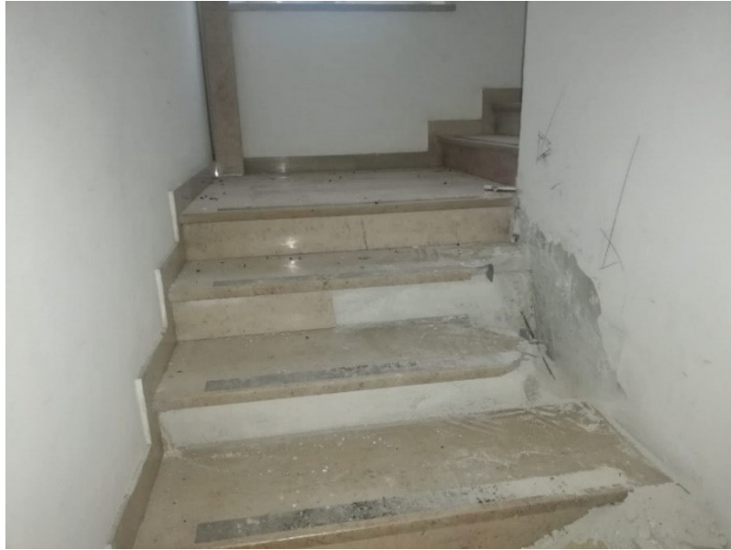
Figura 5.21: Particolare dell'assenza di collegamento tra scala e nucleo ascensore
