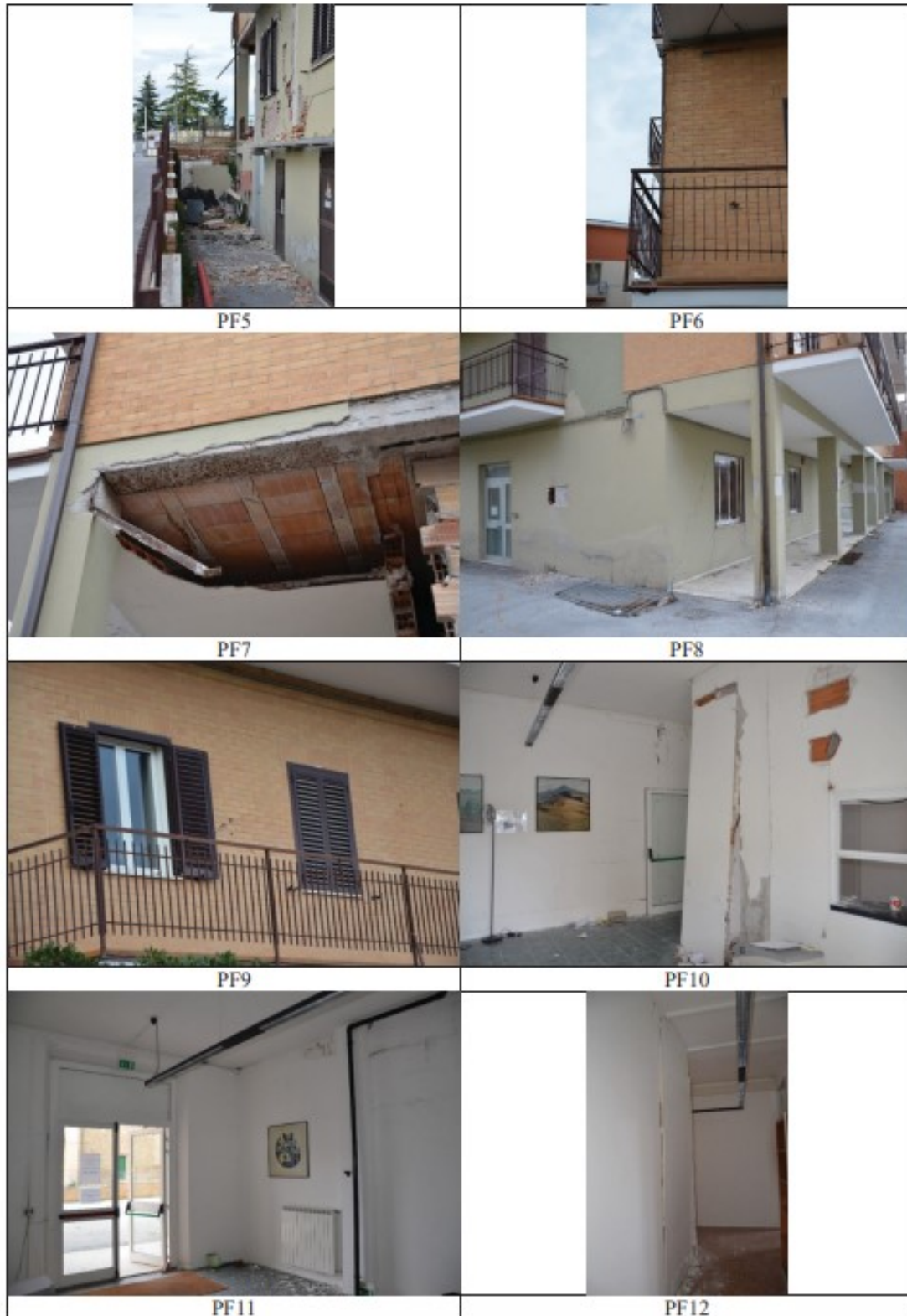
Figura 5.34: Danni sismici rilevati al pianoterra.
