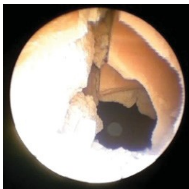
Figura 5.27: Prova Endoscopica di un solaio
