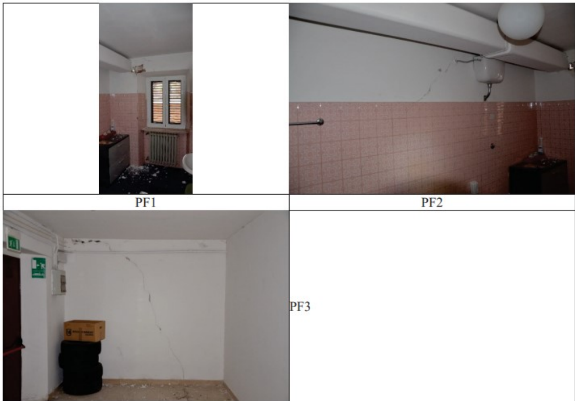
Figura 5.32: Danni sismici rilevati al piano seminterrato.
