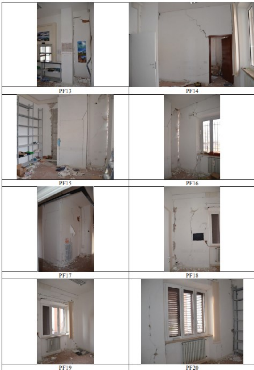
Figura 5.35: Danni sismici rilevati al pianoterra.
