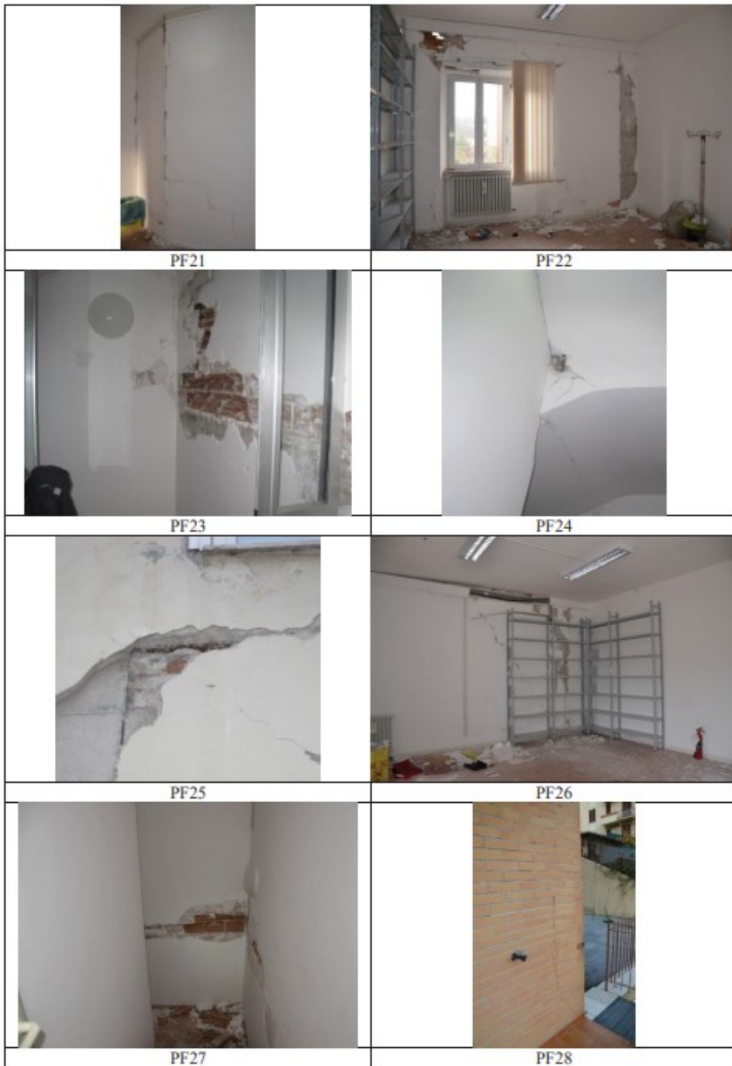
Figura 5.36: Particolari dei danni sismici rilevati al pianoterra.
