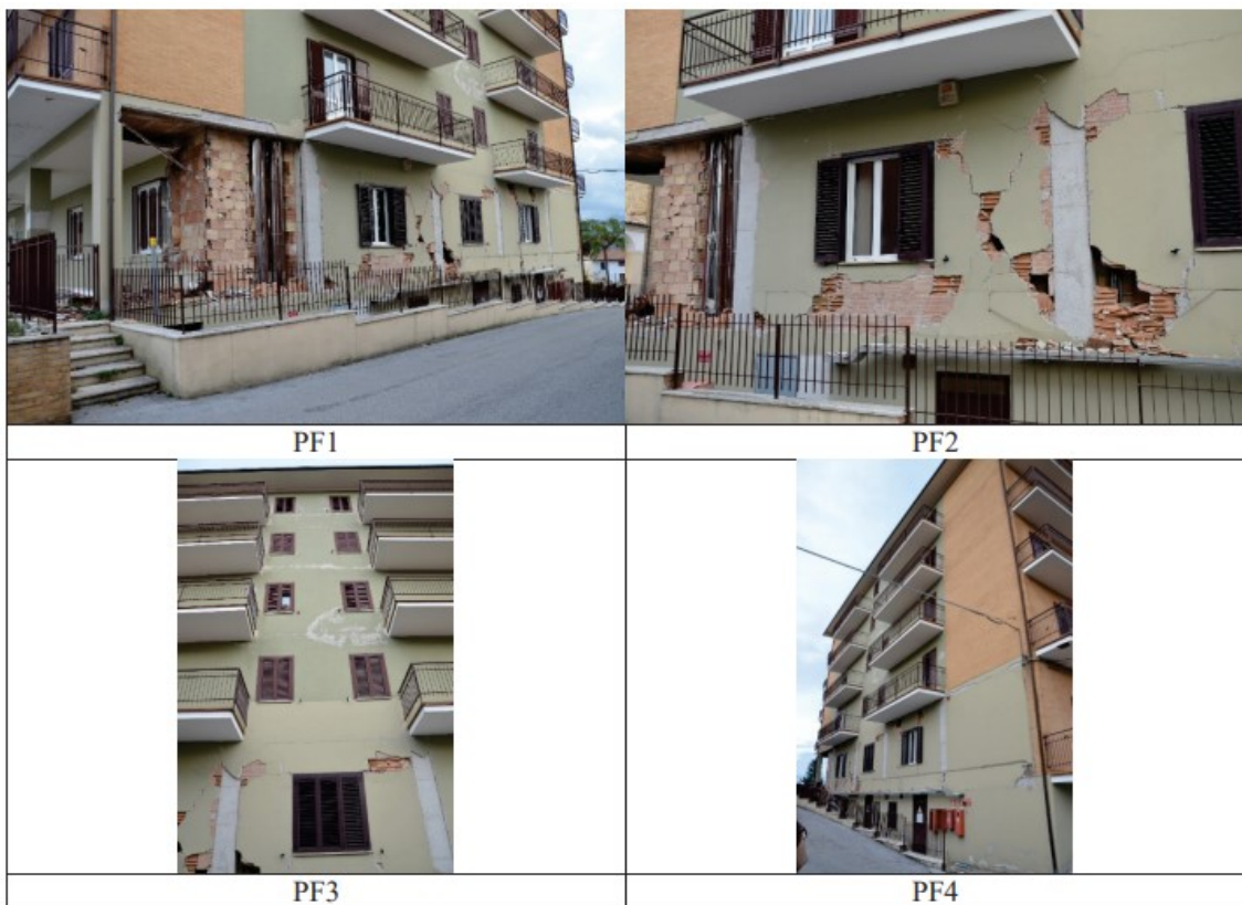
Figura 5.33: Danni sismici rilevati al pianoterra.
