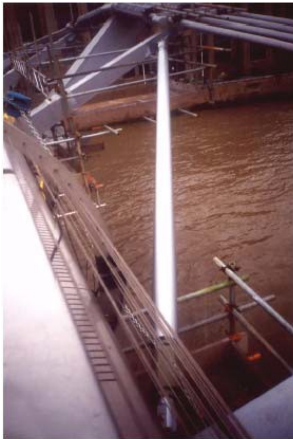
Figura 3.20: Dissipatori in posizione orizzontale sulle ali della passerella
