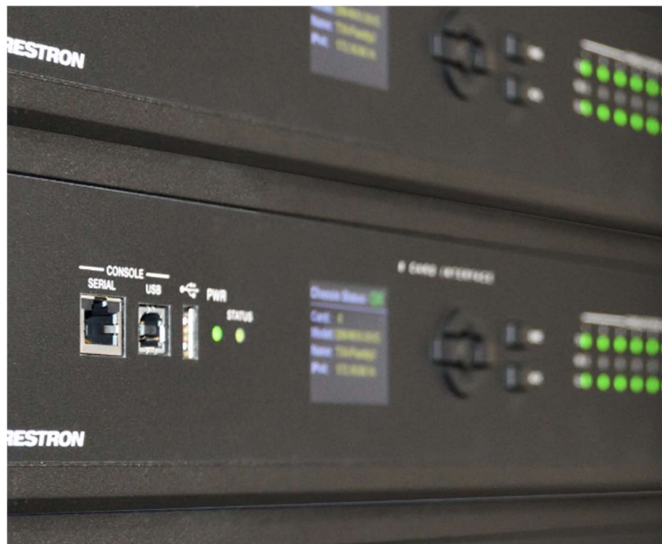
Figura 7: esempio di Crestron box
