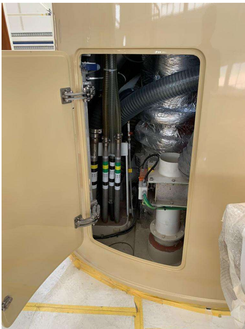
Figura 13: antenne all'interno del fumaio
