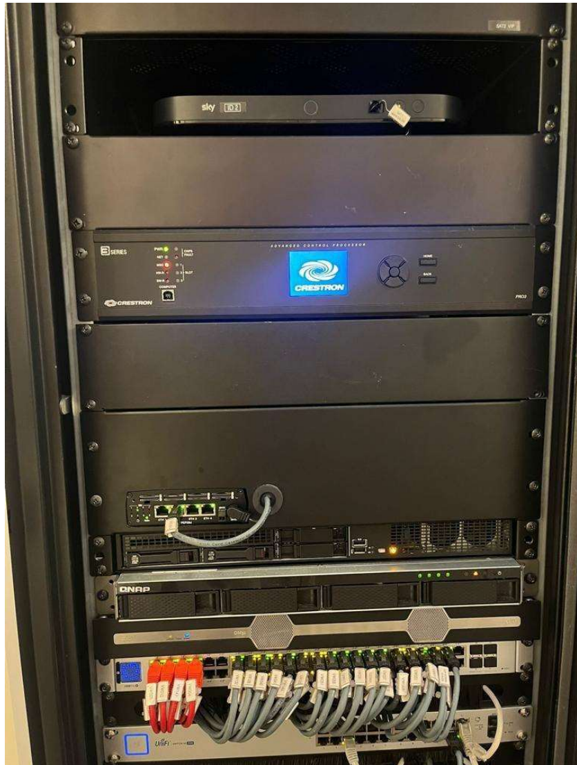
Figura 8: Crestron box all'interno del rack
