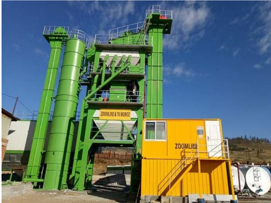
Figura 26: Torre di miscelazione
