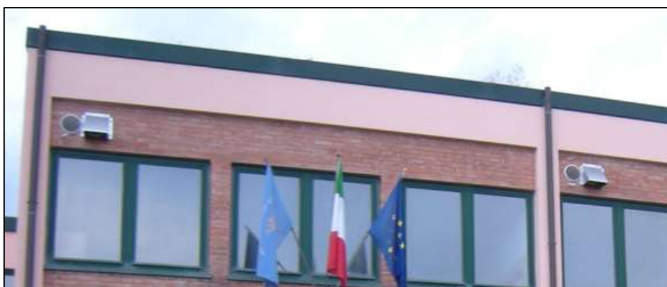
Figura 3.18 - Posizione della presa dell'aria esterna (sezione circolare) e della presa dell'aria estratta (sezione con lamiera) dell'unità VMC
