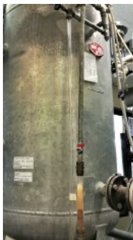
Figura 29. Serbatoio con presa di pressione
