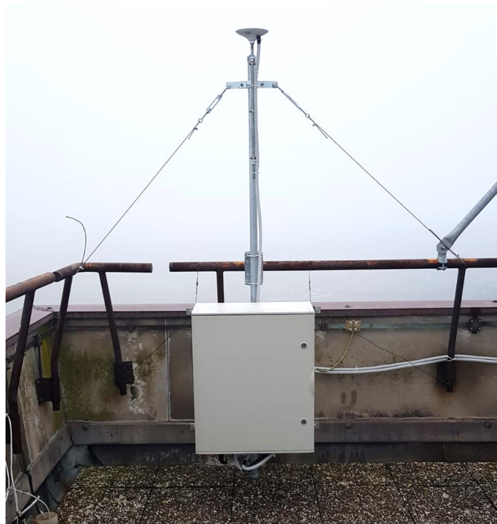
Fig.1 - Immagine dell'installazione terminata
