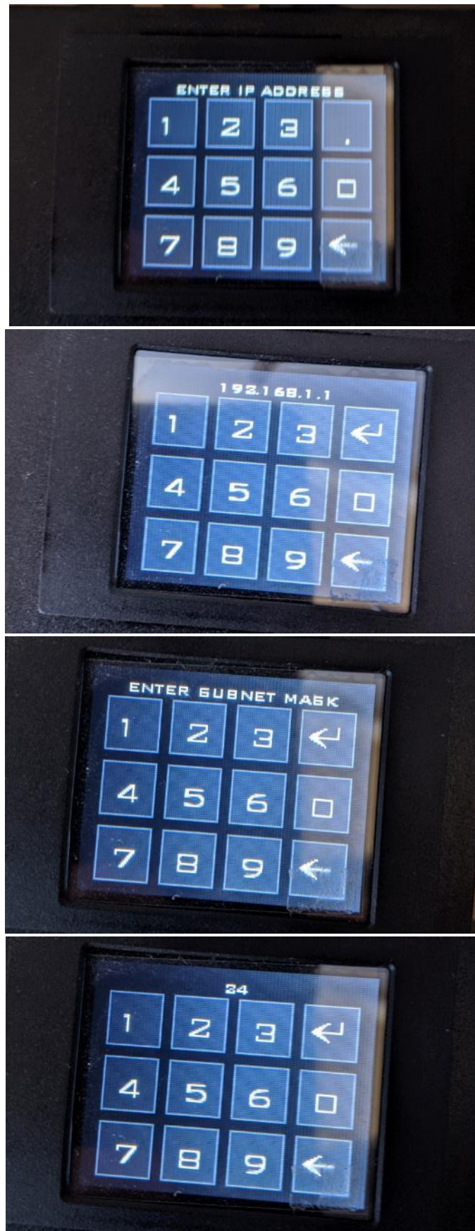
Immagine 7.7– Ripristino Router: assegnazione IP all'interfaccia ETH1 del router (3)
