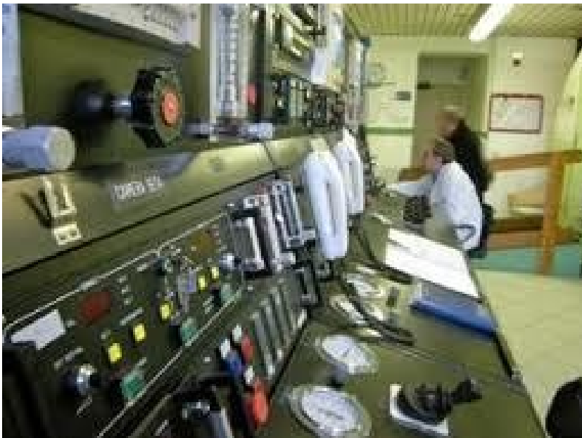
Foto 2 Pannello di controllo
