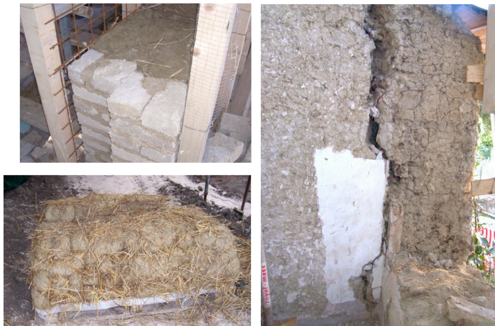
Figura 22 - mattoni in crudo e paglia (in alto); massoni fatti in cantiere (in basso); una delle lesioni ripristinate e consolidate (a destra) (fonte: Lavori di Restauro, Gavioli)
