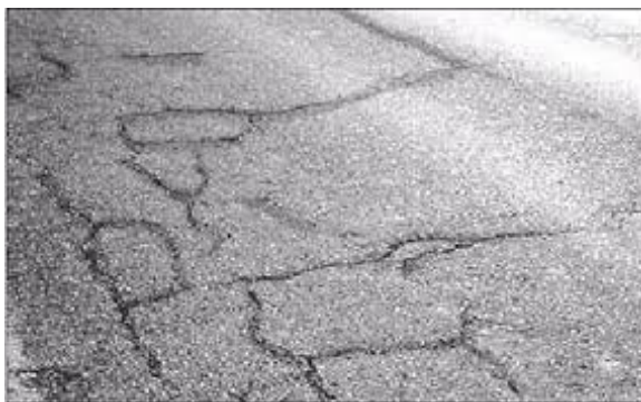
Figura 2.2.2-3 Fessurazione a blocchi
