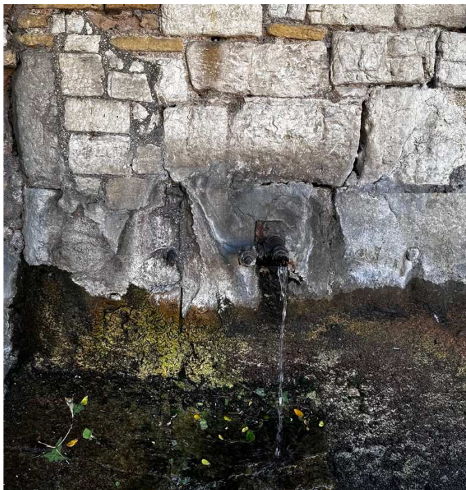
Fig. 3.1.8 – Flusso in uscita dal muro al 5/06/24, si vede che il muro secondario, a sinistra, è completamente asciutto. Sintomo che l'acquifero si avviava verso il completo esaurimento.
