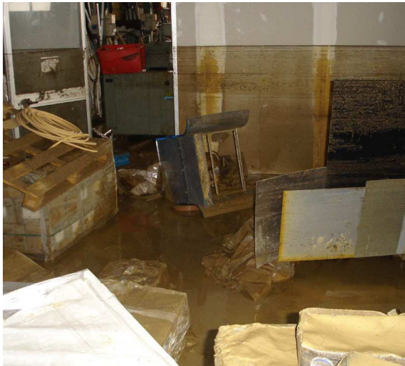
Figura 33: Effetti degli allagamenti all'interno di un capannone industriale
