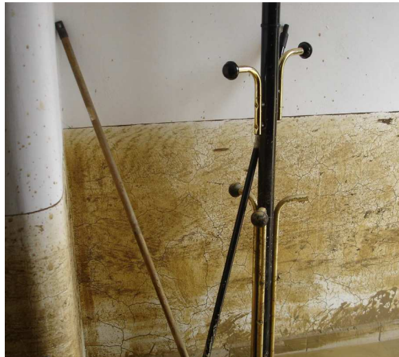
Figura 34: Livello raggiunto dall'acqua all'interno di una abitazione
