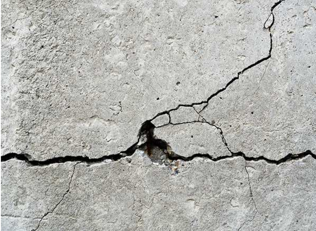
Figura 1.14 Crepa superficiale nel calcestruzzo
