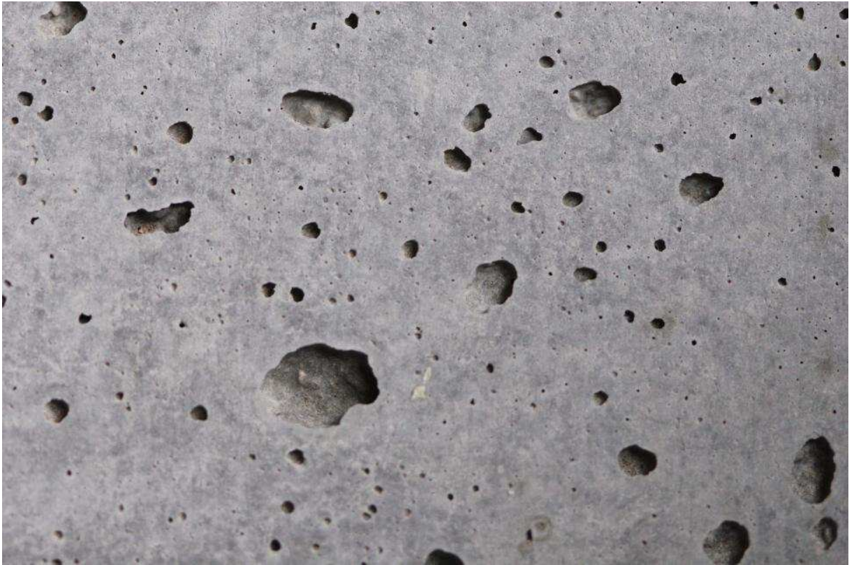
Figura 1.15 Superficie con pitting
