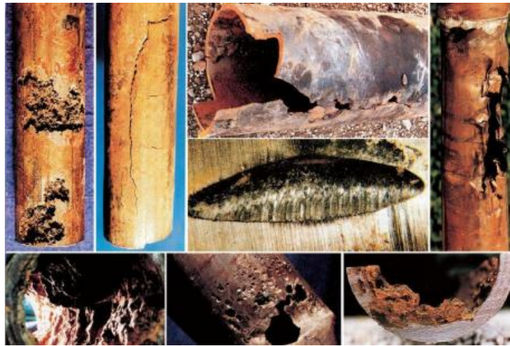
Figura 1.1: Esempi di corrosione localizzata (pitting) in tubazioni metalliche.
