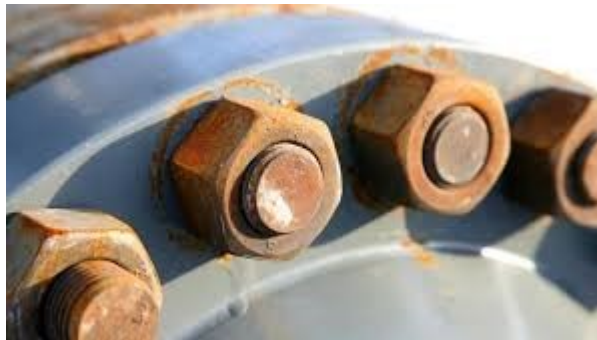
Fig 3.2 esempio di corrosione galvanica
