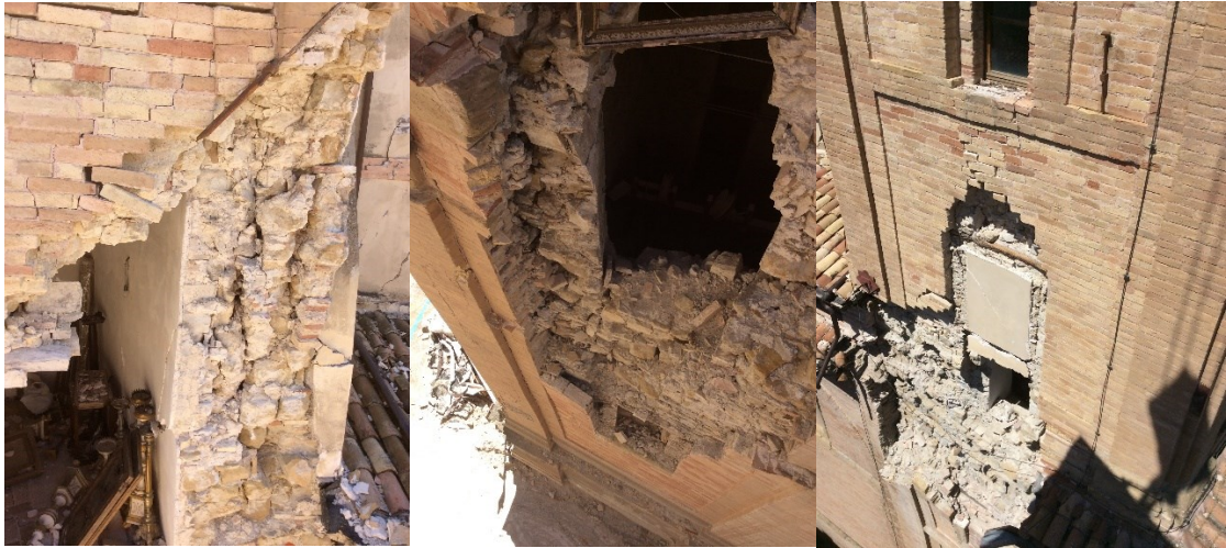
Figura 62 Crolli e disgregazione della muratura a sacco
