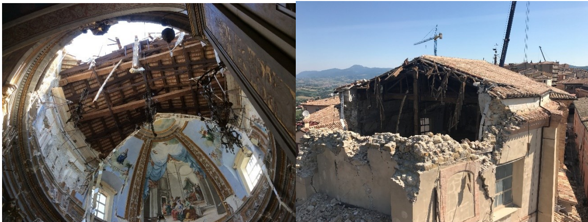
Figura 54 Danni riportati al tiburio. Vista interna e esterna.
