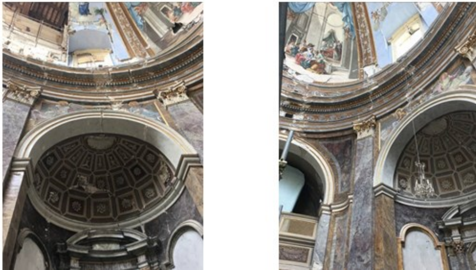
Figura 63 Lesioni sugli archi e sulle cappelle radiali più vicine alla facciata, interessate dal meccanismo di ribaltamento fuori dal piano
