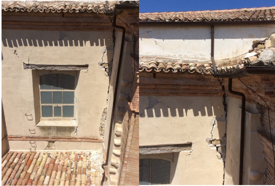
Figura 60 Lesioni nel tiburio che testimoniano il meccanismo di ribaltamento
