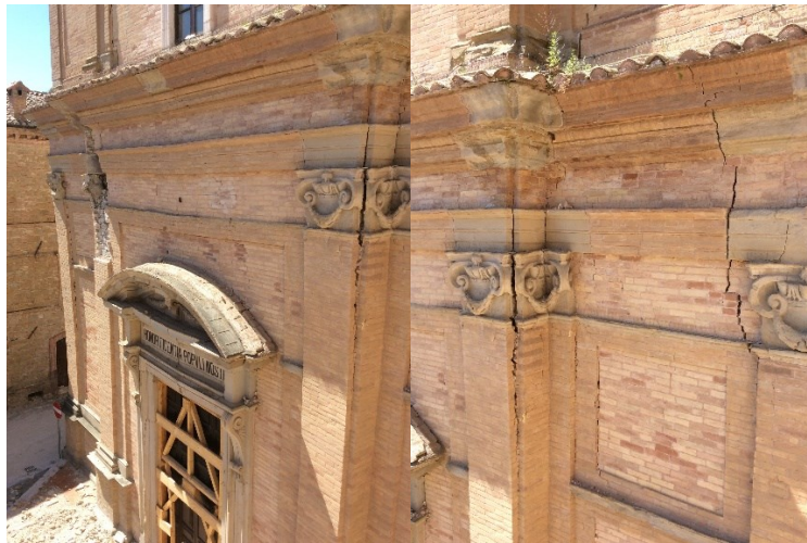
Figura 61 Distacchi nel corpo di facciata
