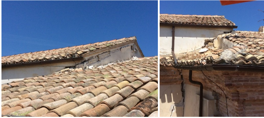
Figura 56 Lesione da distacco dovuta al cinematismo della facciata
