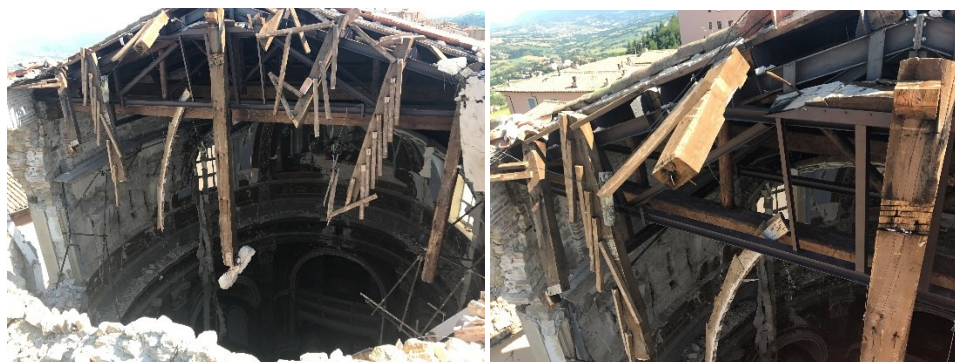
Figura 55 Orditure pericolanti della parte posteriore del tiburio
