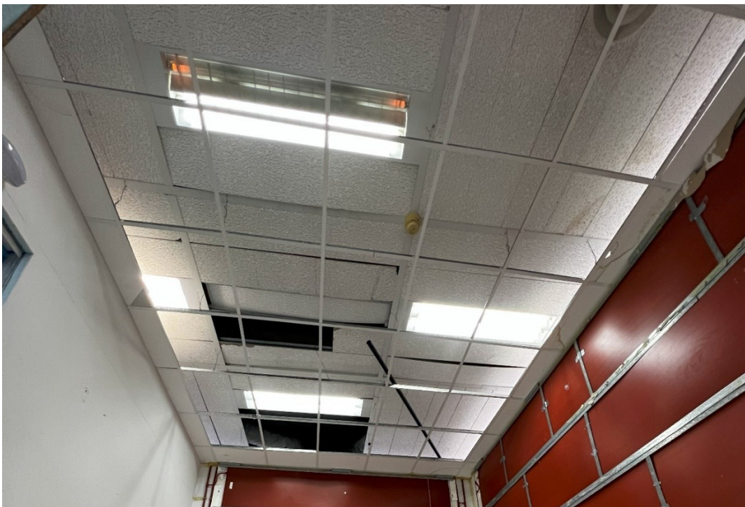
Figura 48: Test Room con controsoffittatura assente
