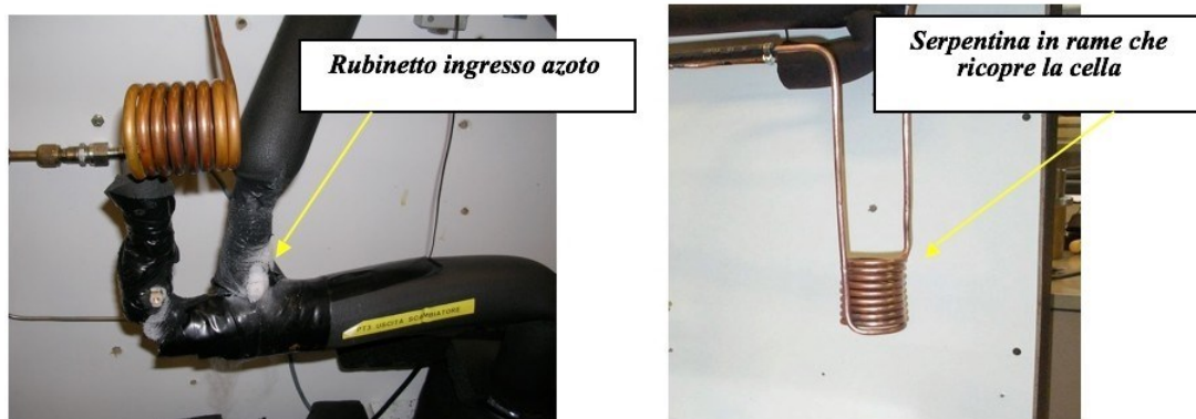
Fig. 2.3. Serbatoio ingresso azoto e serpentina in rame
