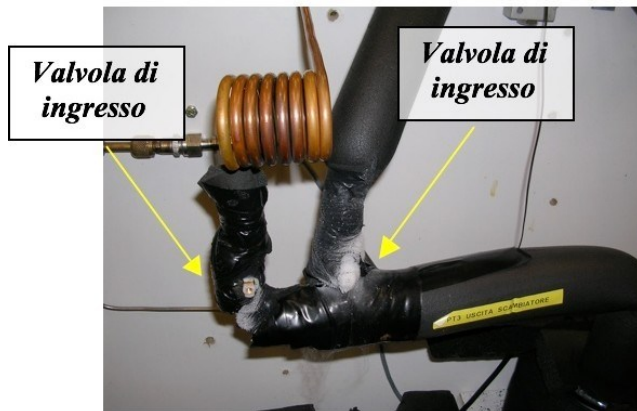
Fig. 2.7. Valvole dei due circuiti
