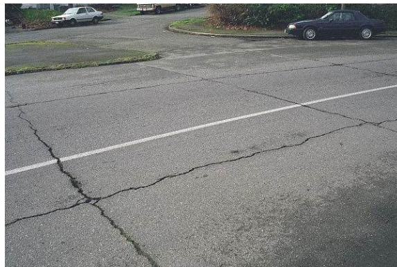
Figura 2.3_2 – Fessurazioni longitudinali e trasversali
