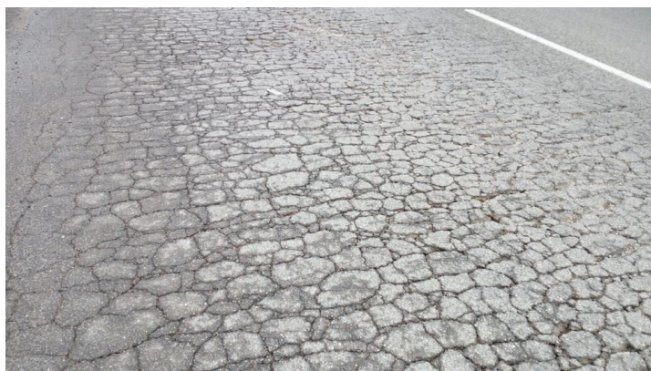
Figura 2.3_1 – Fessurazione a pelle di coccodrillo
