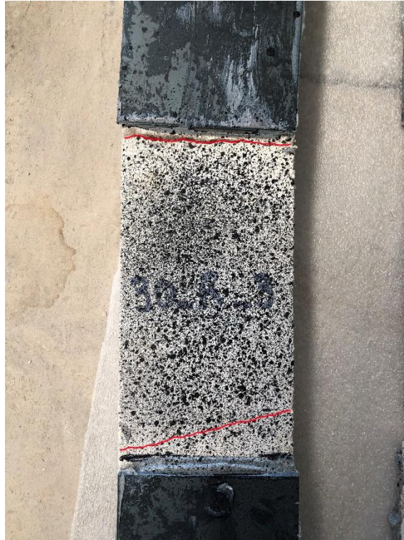
Figura 37 - Provino TRM 30_R fessurato.
