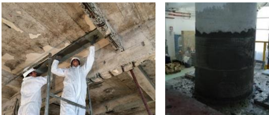
Figura 19 - Rinforzo a flessione di trave mediante placcaggio con strisce di tessuto unidirezionale realizzate con rete di acciaio e malta cementizia (a sinistra); Confinamento di pilastro con tessuto metallico unidirezionale e malta (a destra).
