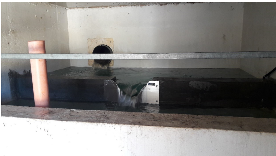
Figura 25 - misuratore di portata
