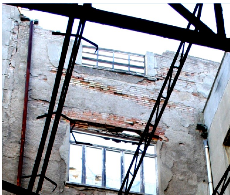
Figura 2.1.2 – vista in dettaglio della parete rimasta in piedi
