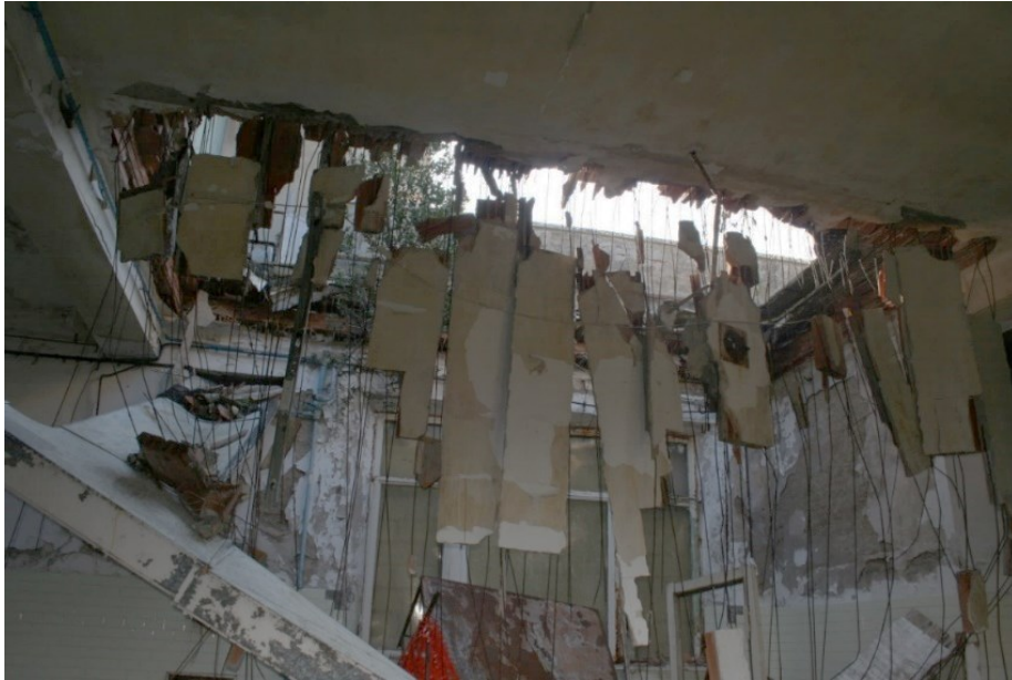
Figura 2.1.3 – parte di solaio crollato
