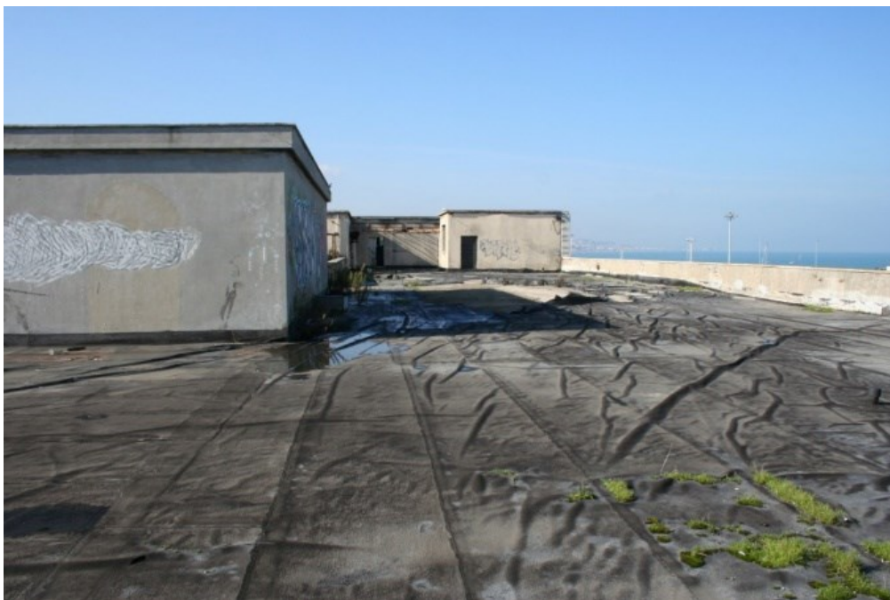
Figura 2.1.5 - Particolare del manto di copertura deteriorato
