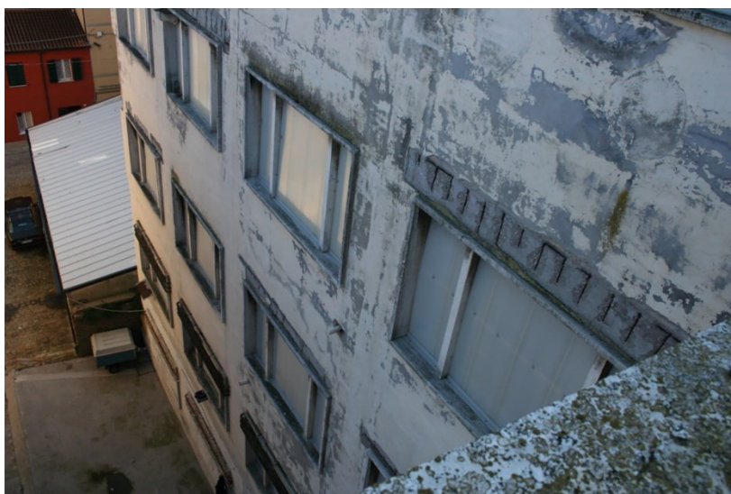
Figura 3.2.1 - Particolare distacco dell'intonaco su uno dei fronti interni dell'edificio A
