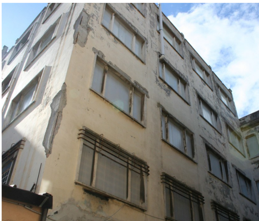
Figura 3 – Particolare del distacco del copriferro
