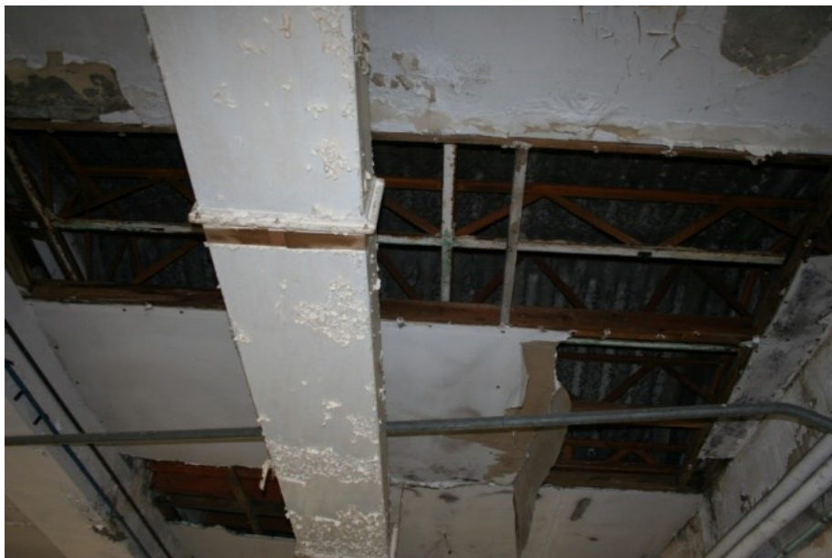
Figura 2.1.4 – Particolare dei controsoffitti crollati
