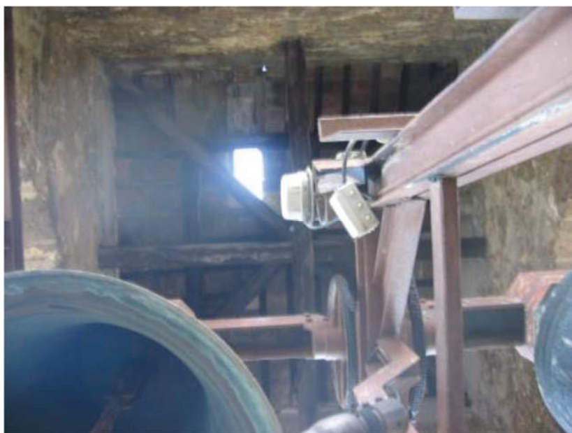
Figura 6.35 Copertura danneggiata della torre campanaria
