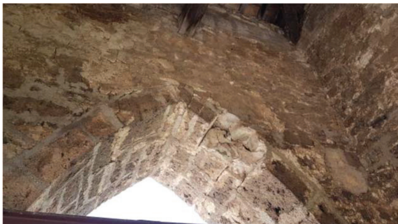
Figura 6.34 Parti murarie lesionate della torre campanaria
